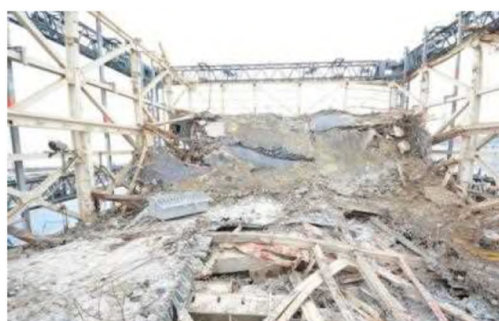
南側崩落屋根の状況
