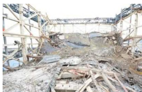
南側崩落屋根の状況
