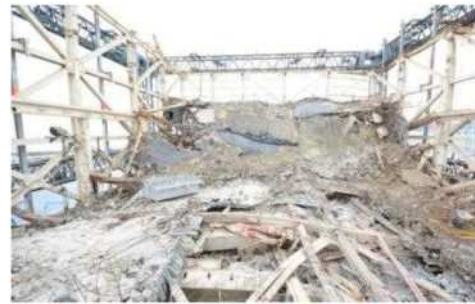
南側崩落屋根の状況
